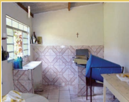
Figura 1 – Presença de móvel de madeira (mesa), imagens de santos, falta de telas nas janelas e falta de forro no teto.
