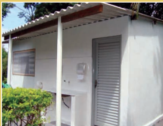
Figura 3 – Construção de cobertura para proteção da chegada do leite, entrada do leite via recipiente externo ao lado da pia, pia para higienização do produtor dos queijos com lavagem das mãos e botas e telas nas Janelas.
