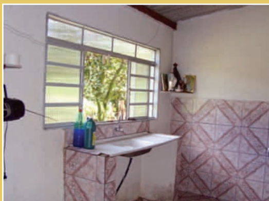
Figura 2 – Paredes sem impermeabilização permitida (anexo 22), presença de mofo na pia, pia de material não permitido (anexo 22) e quebrada, produção e local de embalagem e armazenamento sem separação.
